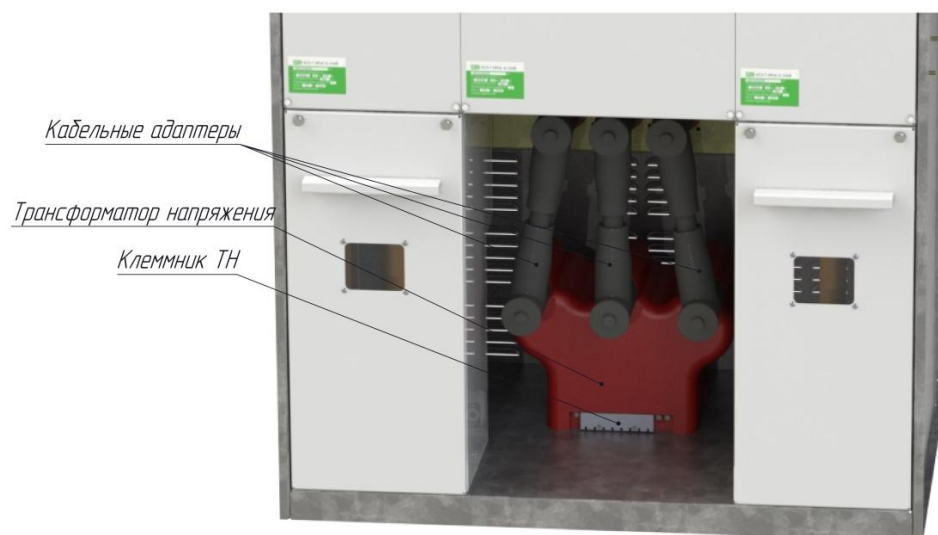
Рис. 7.4 ТН установленный в кабельном отсеке
