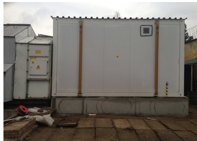
Установленное БМ ОПУ
