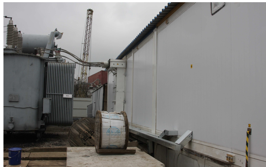
Установленное БМ ЗРУ-1
