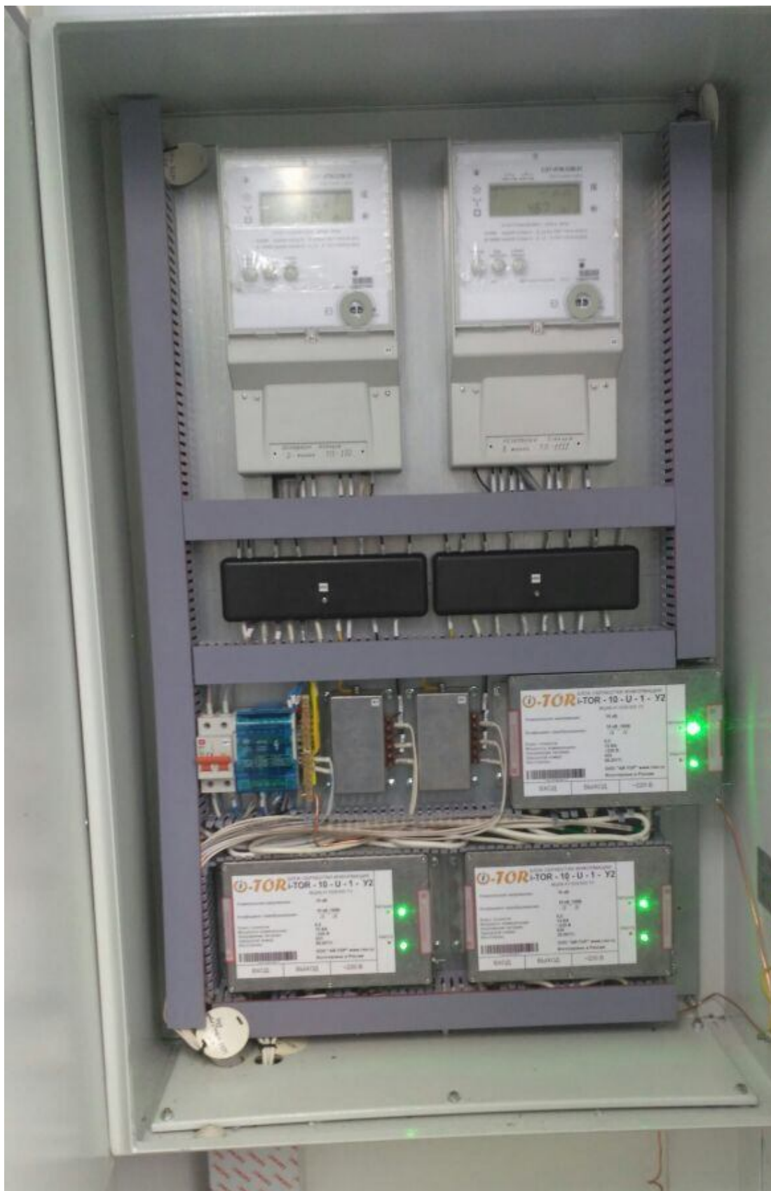
Шкаф учета электроэнергии с блоками обработки информации устройства измерения напряжения типа i-TOR-6/10-U.
