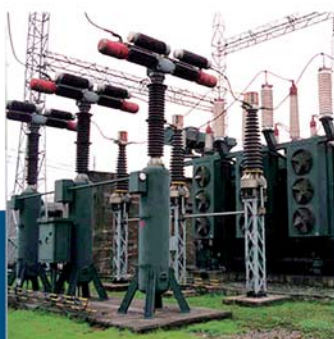
Выключатель 110 кВ воздушный
